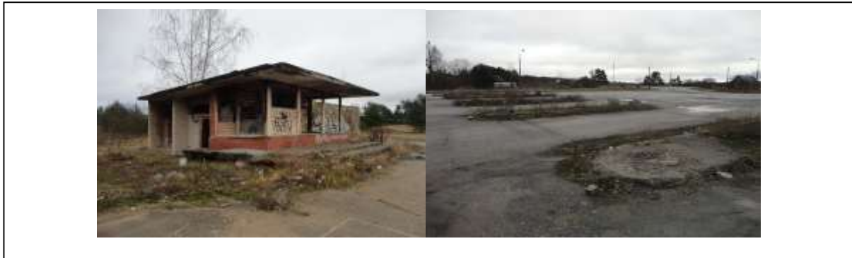
3. attēls. Degradēta DUS ēka un palīgkomunikācijas
