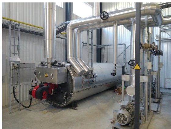
2.att. Gāzes katls
